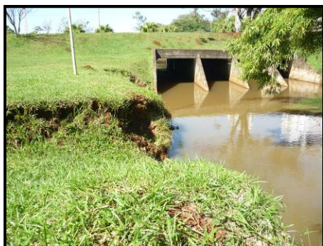
Figura 9: Erosão a jusante
