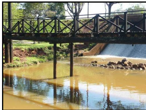
Figura 8: Solo exposto abaixo da ponte
